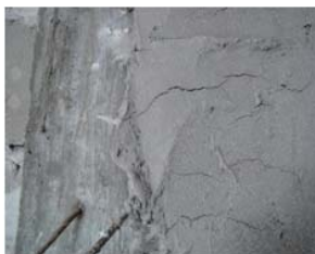
(2) 现场搅拌砂浆收缩率大，容易开裂
